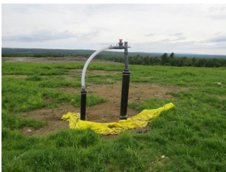
Figure 7 : Système de captation des biogaz
